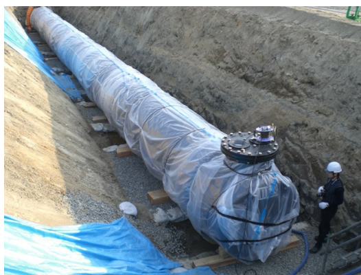
図4.2 耐震性貯水槽 (写真：総社市提供)
